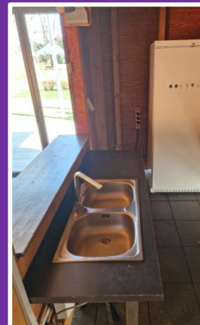
Doppelspülbecken mit Warmwasser
