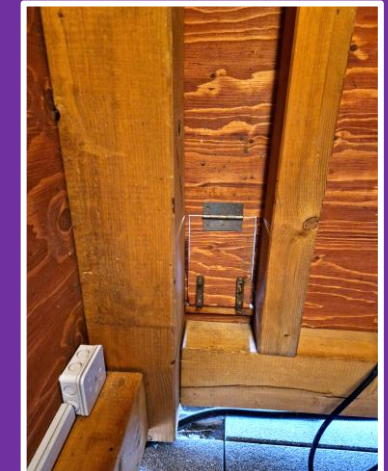
Klappe für Strom nach draußen
